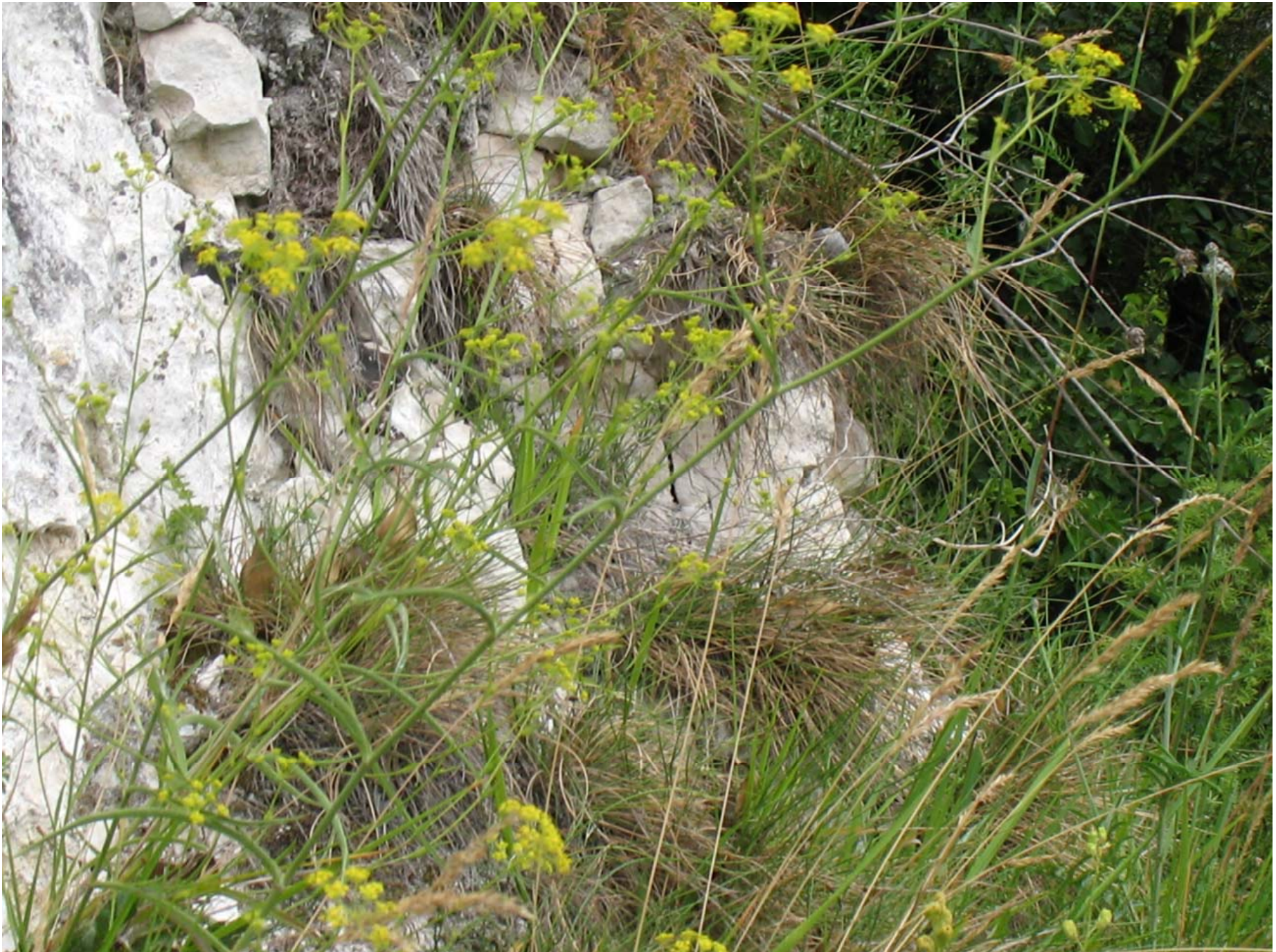
Graminées dans les fissures
